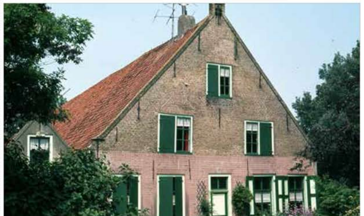
De 'Kwakstee' (ca.1760), Tweede Weg 1, Melissant. Dit monument vertoont zeer achterstallig onderhoud en wordt daardoor bedreigd.
