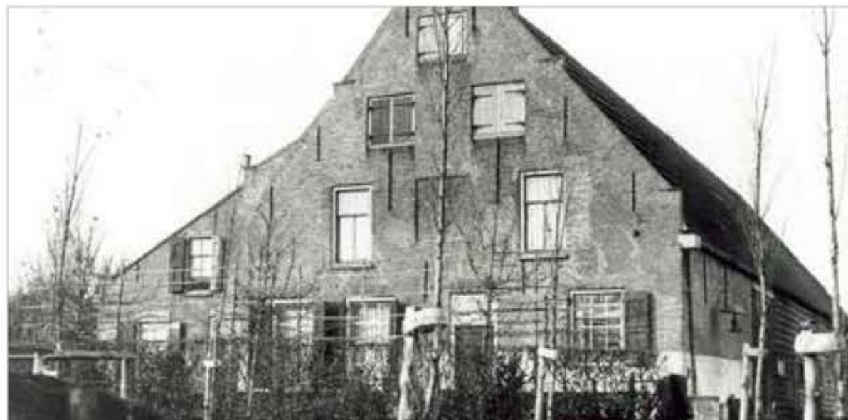
Deze naamloze hoeve (1746), Zeedijk 5, Stad aan 't Haringvliet, laat de overgang zien naar het type dat hierna is beschreven. Dit rijksmonument staat al jarenlang leeg, bevindt zich in zeer slechte staat en wordt ernstig bedreigd. De geveltop is al naar beneden gestort.
